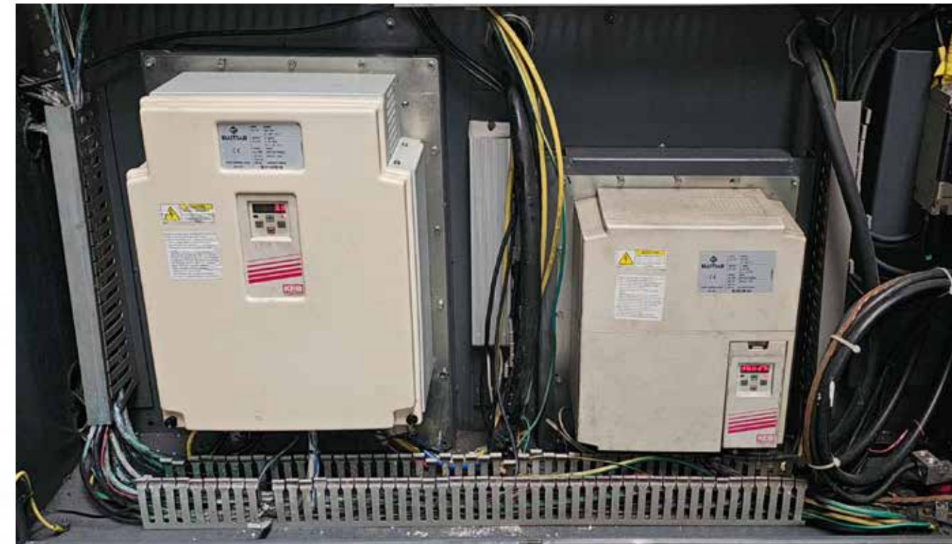
Puesta en marcha de Servodrive tecnología KEB
